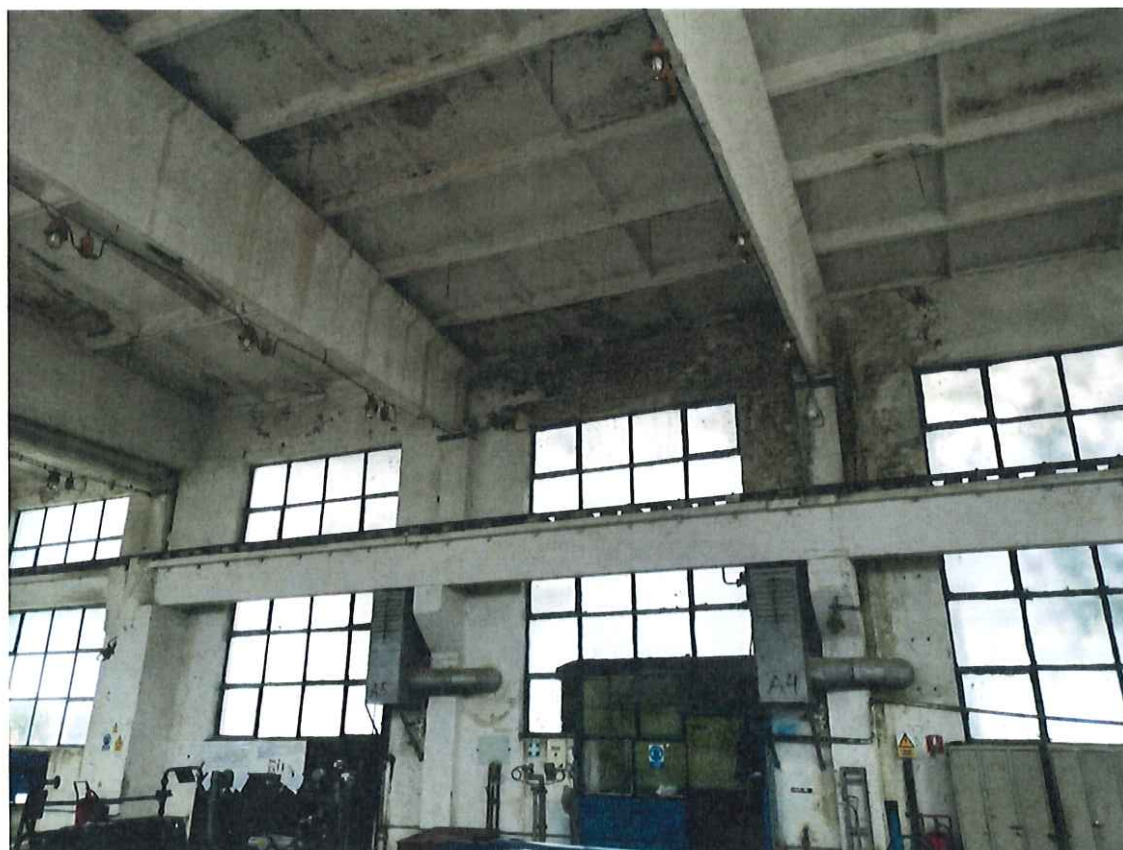
VEDERE INTERIOARA DETERIORARE STRUCTURA BETON ARMAT DATORATA INFILTRATIILOR
