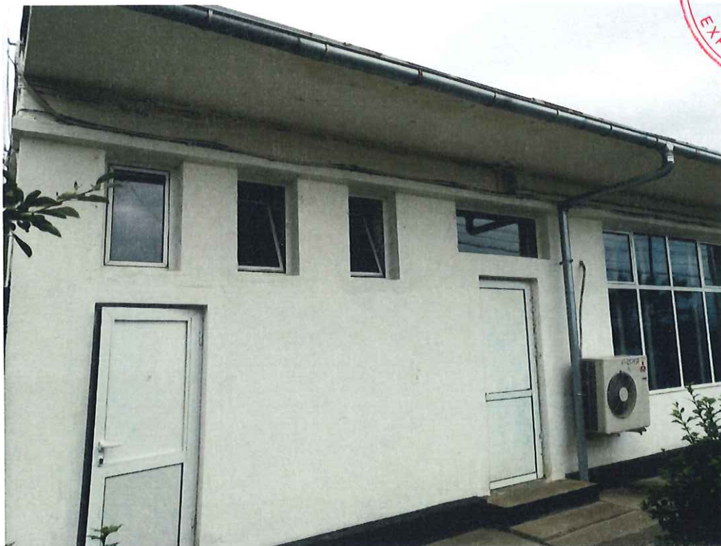
VEDERE DETALIU COPERTINA (HIDROIZOLATIA DEGRADATA A COPERTINEI A CONDUS LA DEGRADAREA FINISAJELOR DE LA INTRADOSUL ACESTEIA)
