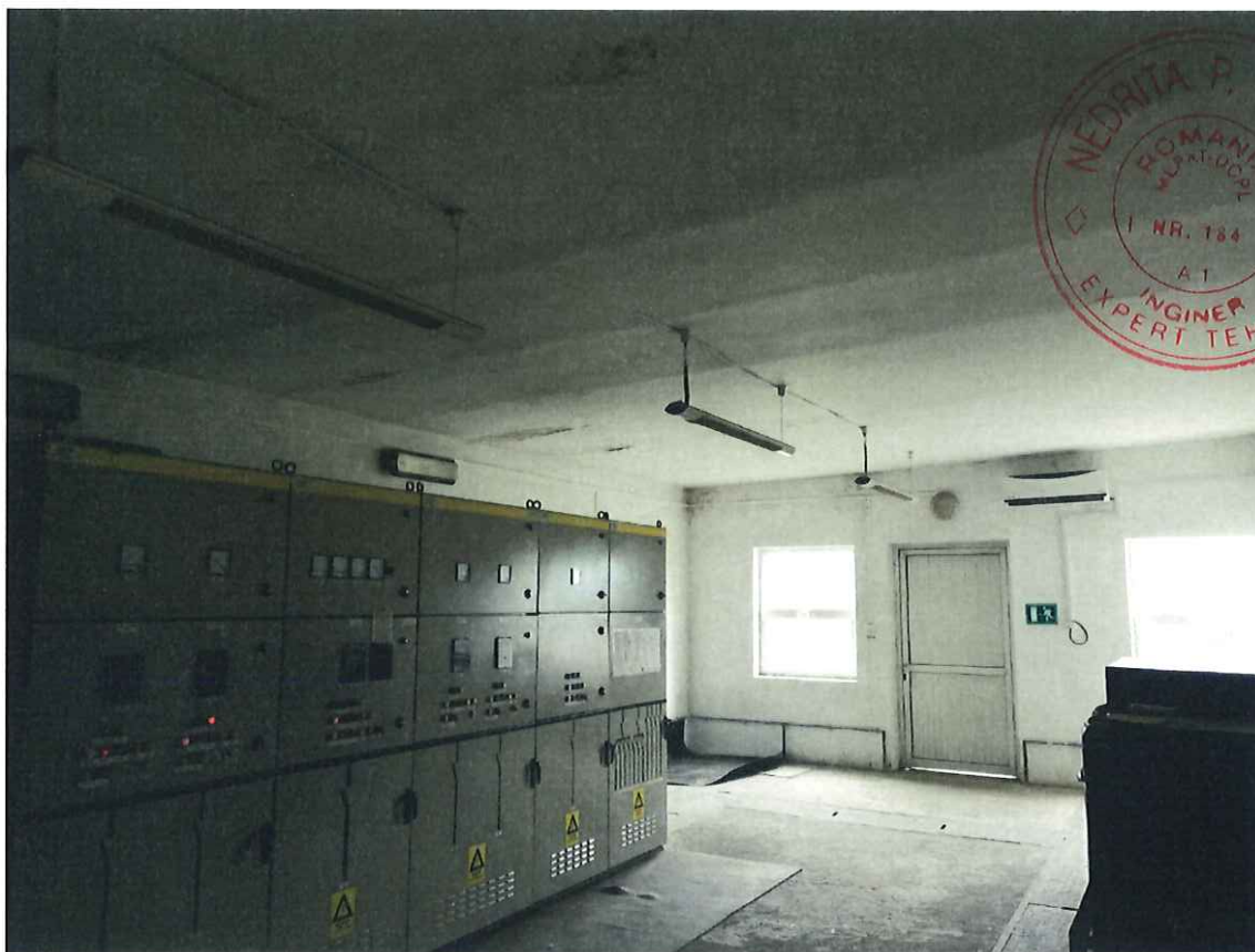
VEDERE INTERIOARA CLADIRE - CORP DISTRIBUTOR E - INFILTRATII PLANSEU.
