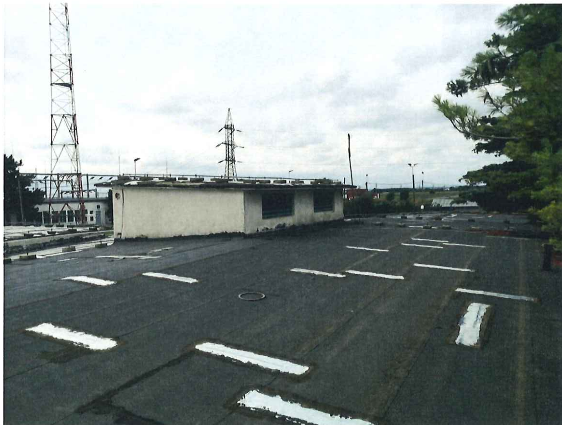
VEDERE ACOPERIS TERASA – DEGRADARI PUNCTUALE SI REPARATII IMPROVIZATE.
