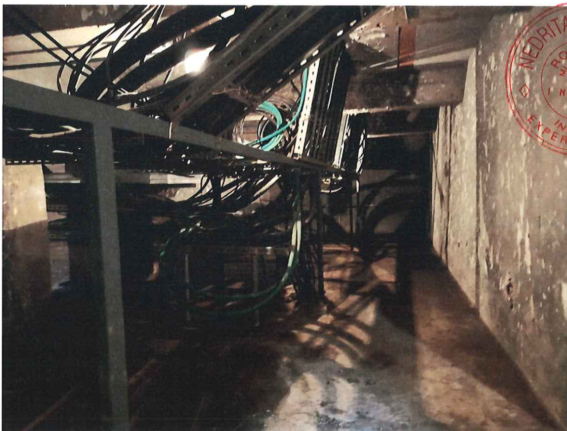
SUBSOL TEHNIC - CORP DISTRIBUITOR C – INFILTRATII PRIN PERETI SI PARDOSEALA.
