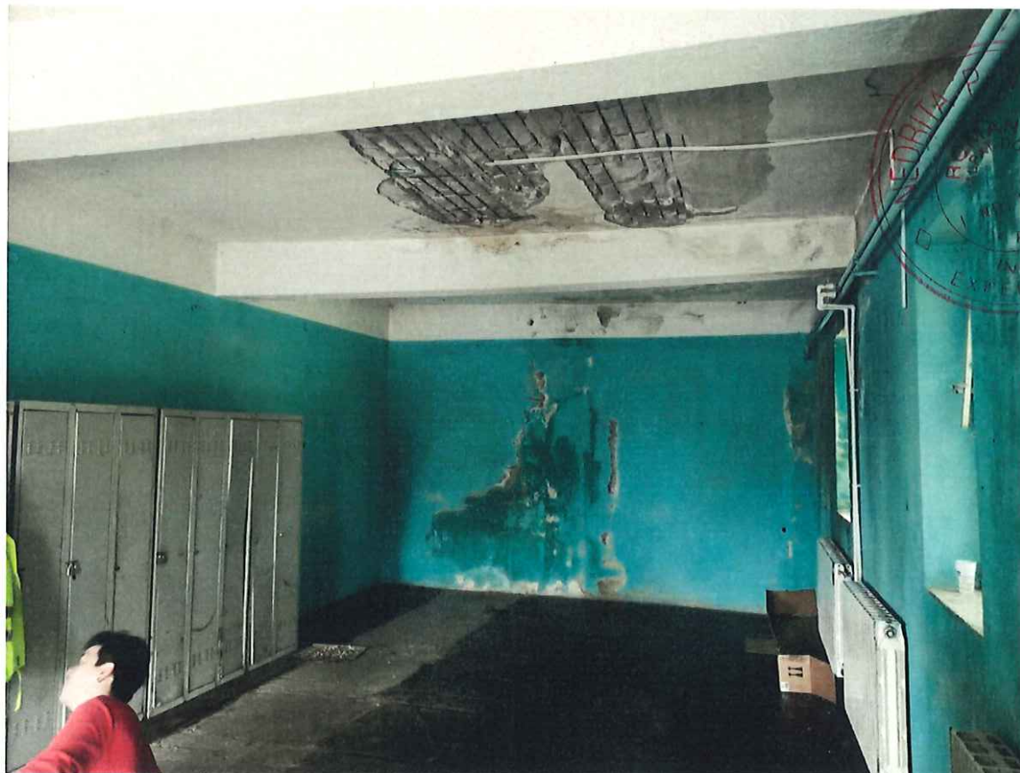
VEDERE INTERIOARA CLADIRE - CORP VESTIAR DISTRIBUTOR C – INFILTRATII PLANSEU/PERETE
