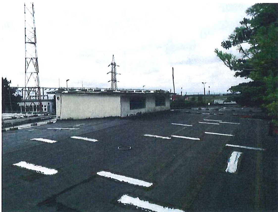
VEDERE ACOPERIS TERASA – DEGRADARI PUNCTUALE SI REPARATII IMPROVIZATE.
