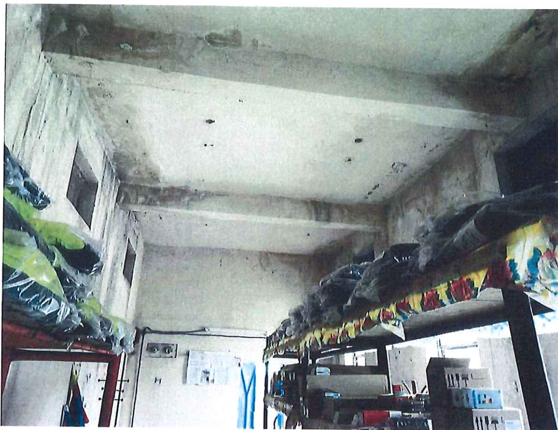
VEDERE INTERIOARA CLADIRE - CORP DEPOZITARE DISTRIBUTOR C – INFILTRATII PLANSEU.
