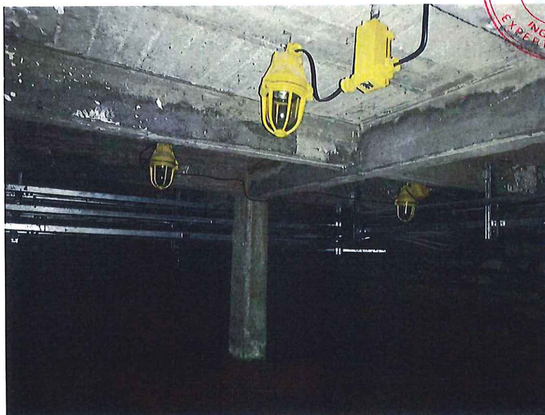
IN SUBSOL SE OBSERVA INFILTRATIILE DIN ELEMENTELE DE FUNDARE PERIMETRALE CAT SI PRIN PARDOSELA DIN PAMANT.
