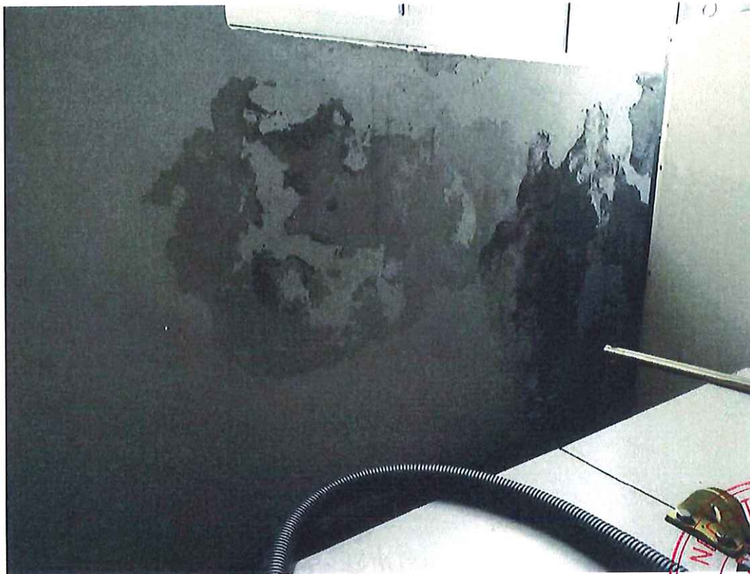
PERETELE NORD-ESTIC ESTE AFECTAT DE IGRASIE.
