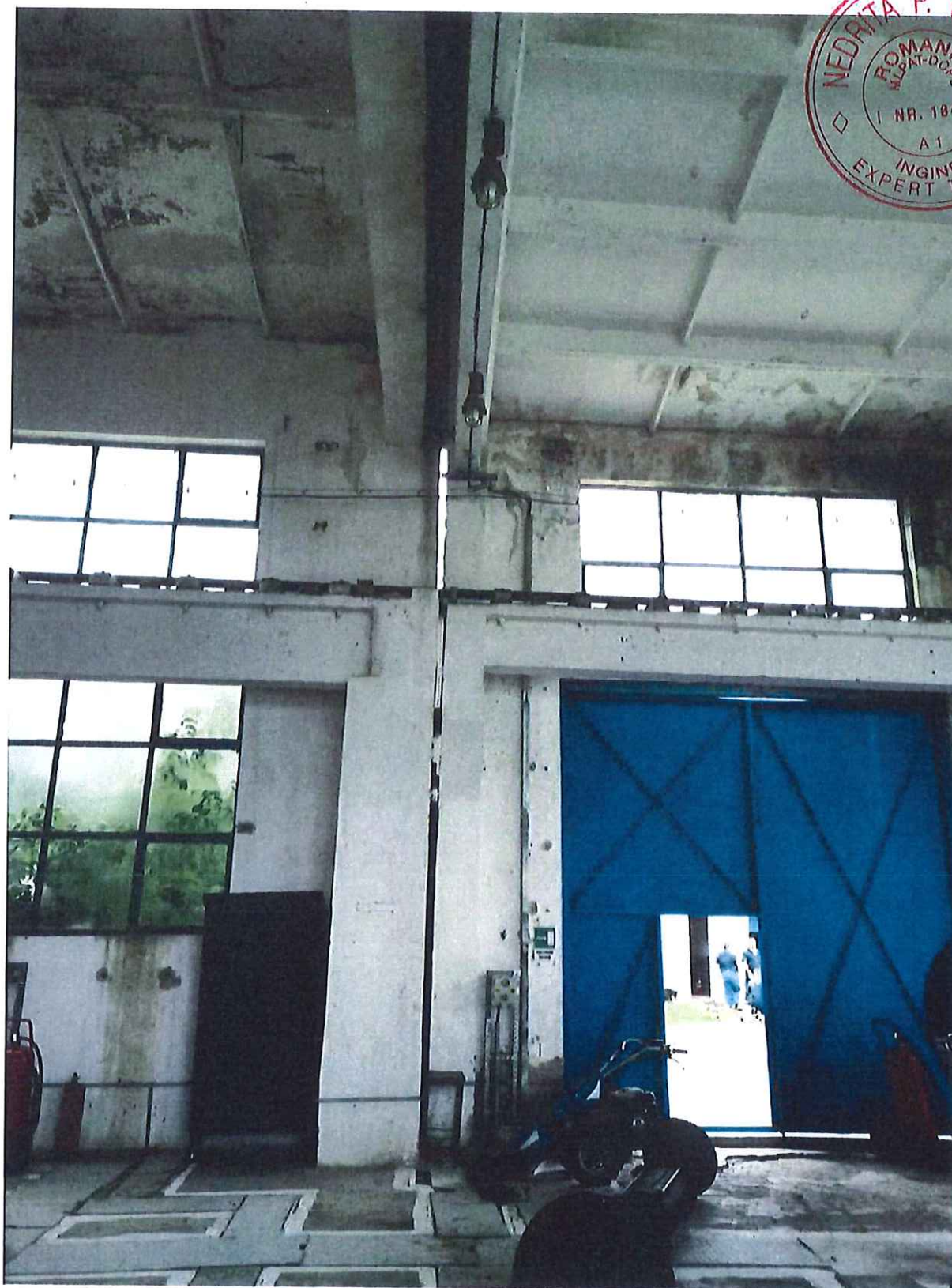
VEDERE INTERIOARA ZONA ROST - DETERIORARE STRUCTURA BETON ARMAT DATORATA INFILTRATIILOR
