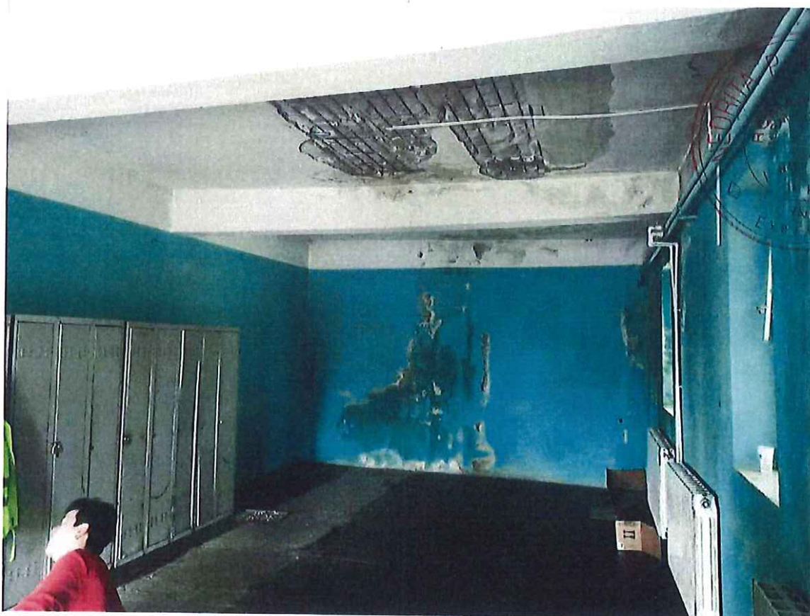
VEDERE INTERIOARA CLADIRE - CORP VESTIAR DISTRIBUTOR C – INFILTRATII PLANSEU/PERETE
