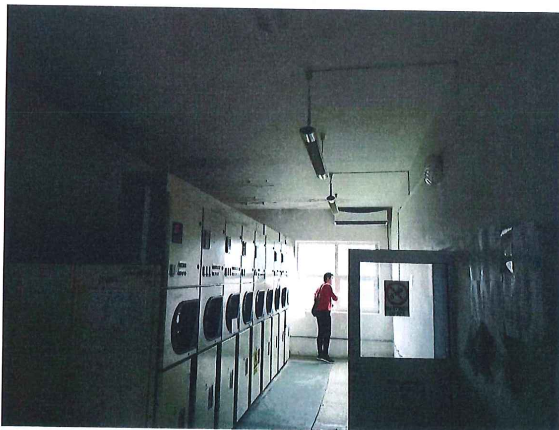
VEDERE INTERIOARA CLADIRE - CORP DISTRIBUTOR E - INFILTRATII PLANSEU.
