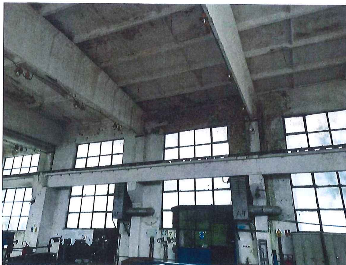
VEDERE INTERIOARA DETERIORARE STRUCTURA BETON ARMAT DATORATA INFILTRATIILOR
